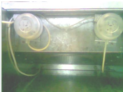
Рисунок 4 – Датчики тиску розміщені в системі приточної вентиляції
