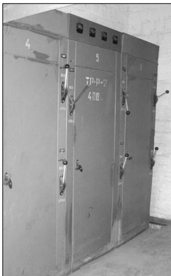
Рис. 61. Частина розподільного пристрою, побудованого на базі панелей ЩО, у підстанції, що підлягала реконструкції
