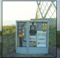
Щит для керування освітленням та обліку електроенергії біля мосту Оресунд, що з'єднує Данію та Швецію
